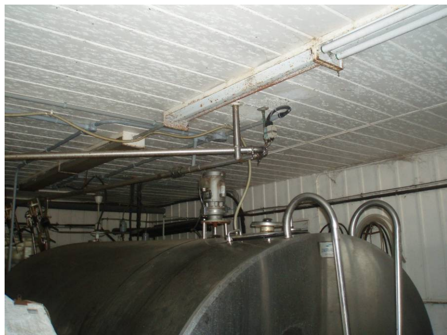
Luminaire non étanche et non résistant à la corrosion
